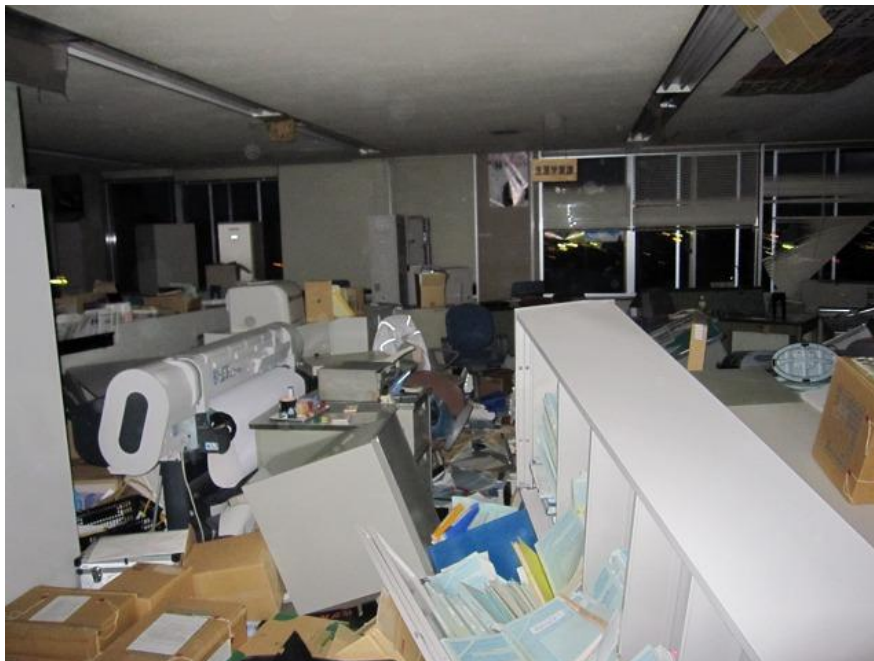
図表1-6 震災直後の県庁西庁舎内
