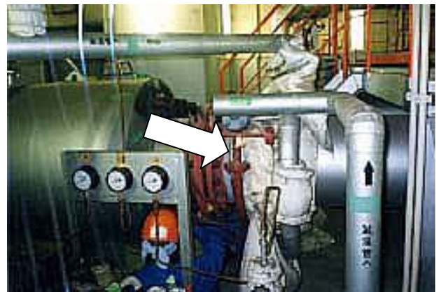
図 4-4-17 蒸気弁保温例
