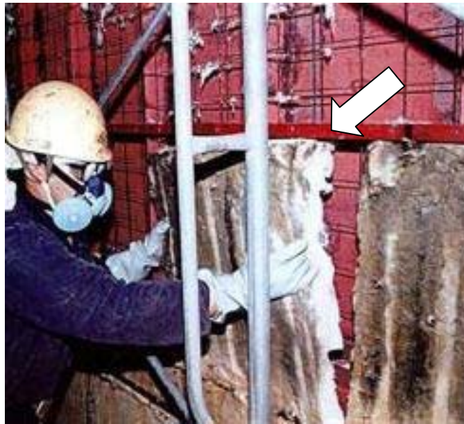
図 4-4-9 電気集じん器保温材等除去例
