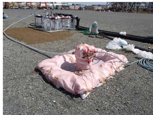
No. iii 貯水槽のポンプ設置状況(4/13撮影)
