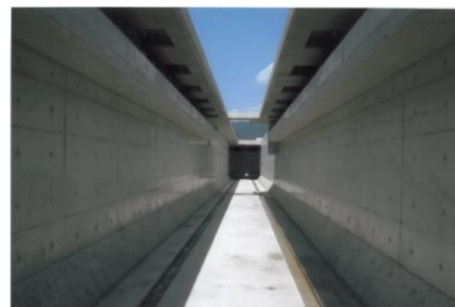
水処理施設 最終沈殿池内部
