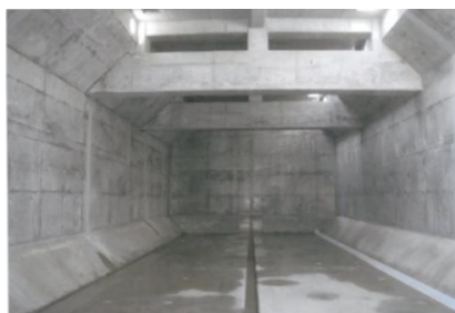
水処理施設 反応タンク内部
