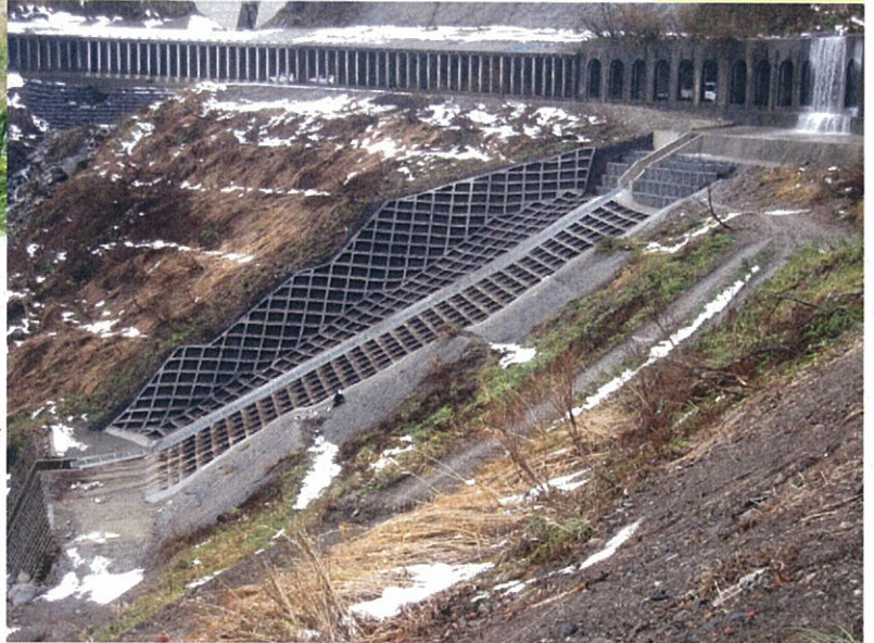
入山1号工区(只見町大字田子倉 字入山1号地内:赤柴沢) 法面処理工事が完了。
