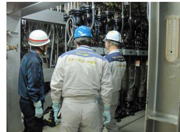
制御棒駆動水圧系ユニットへの立入検査による隔離確認
