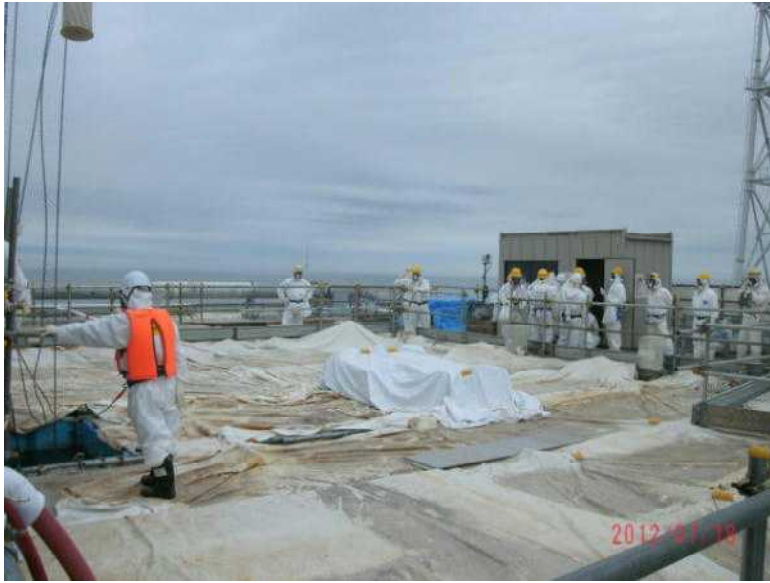
養生された使用済燃料プール上部。写真左の開口部から燃料を引き上げる。 (4号機原子炉建屋5階)
