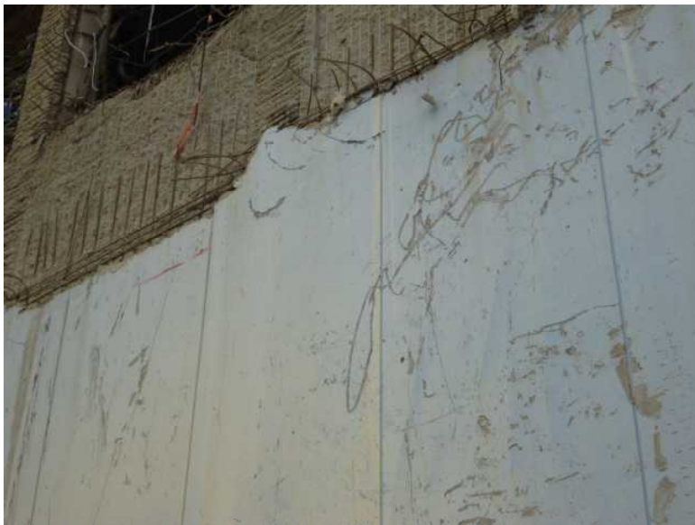
建物の傾きの確認（外壁面の測定）で、33mmの膨らみが確認された「西2（3階）」の測定点 （4号機原子炉建屋の外壁）
