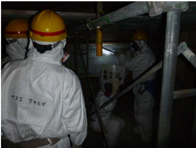
4号機使用済燃料プール下部 の補強箇所 (4号機原子炉建屋2階)
