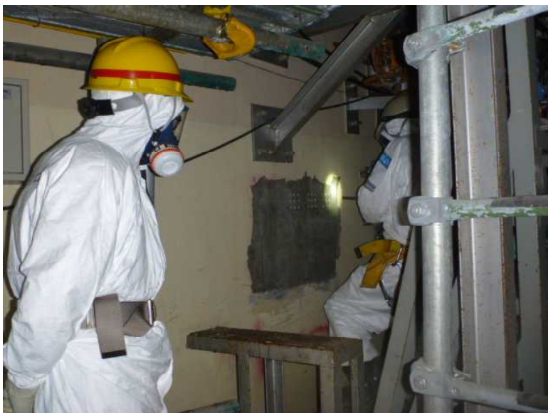
非破壊検査（シュミットハンマー）によるコンクリートの強度確認の状況 （4号機原子炉建屋1階）
