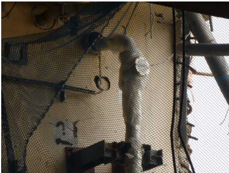
4号機使用済燃料プール冷却系給水配管の逆流防止弁 (4号機原子炉建屋4階)
