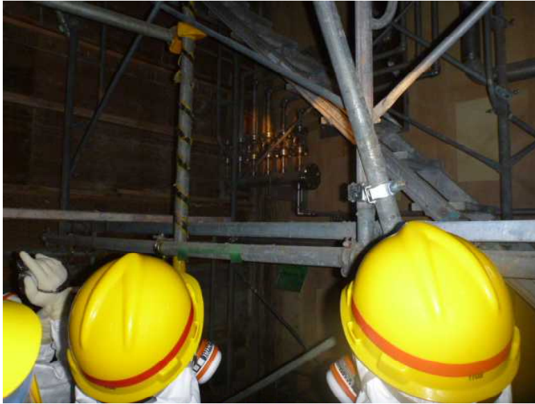
4号機使用済燃料プールからの漏水を集め、監視するためのガラス窓付きの配管 (4号機原子炉建屋2階)
