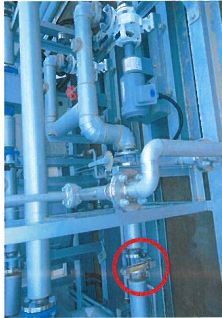
ボイラー給水系のろ過器逆洗ライン流量計
