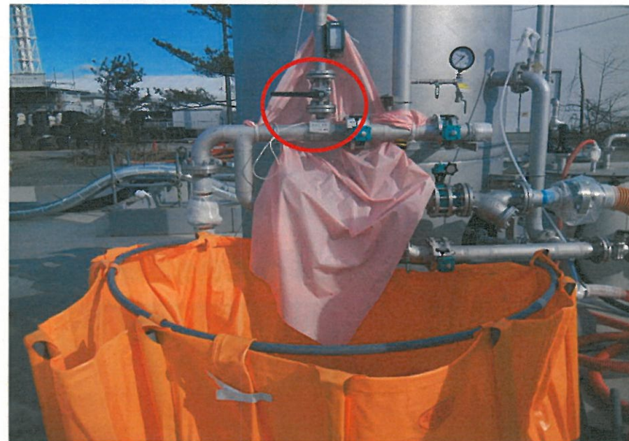
脱塩器入口ラインの弁フランジ部
