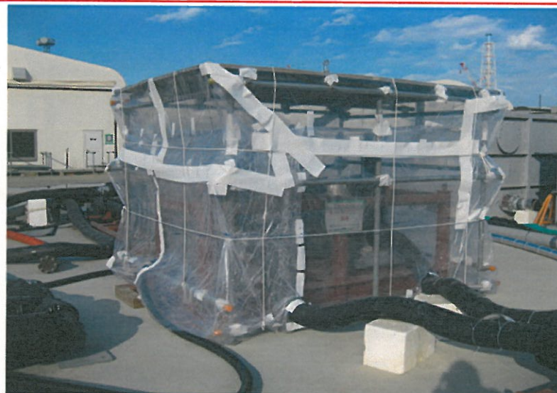
廃液供給ポンプ
