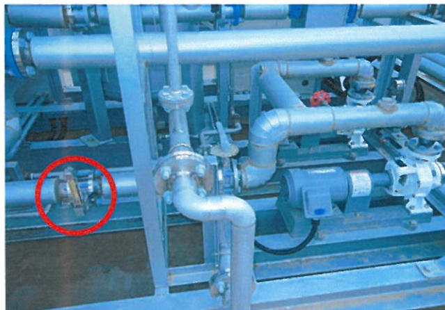
ボイラー給水系のろ過器逆洗ライン流量計
