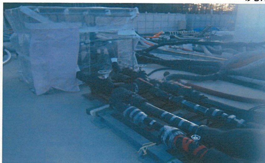
廃液供給ポンプAミニフローライン
