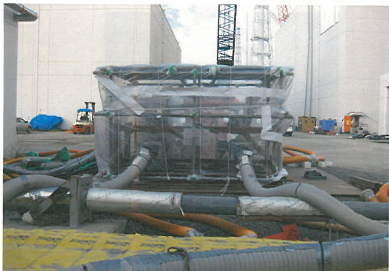
SPT受入水移送ポンプ
