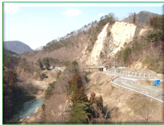
国道399号(福島市飯坂町)地すべり災害被災箇所
