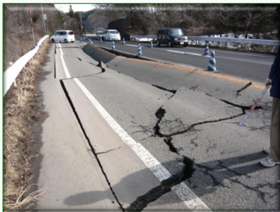
国道115号(福島市土湯)道路災害被災箇所
