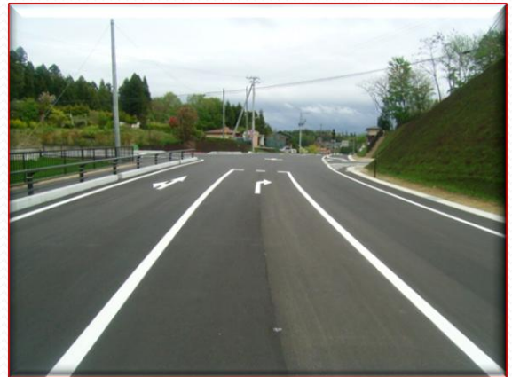
危険箇所解消- 拡幅&歩道新設 :二本松川俣線(二本松市油井)
