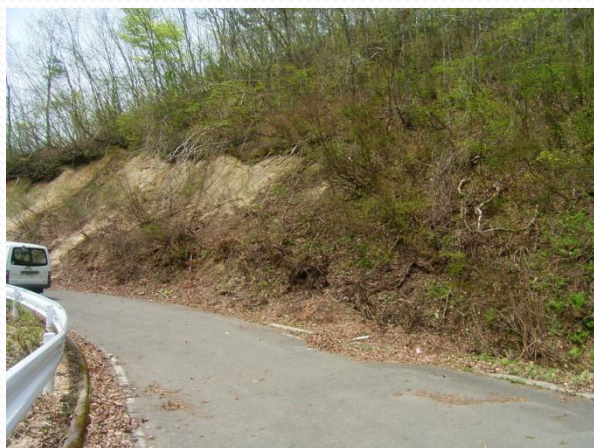
法面崩壊・国道399号鳩峰峠(福島市飯坂町)
